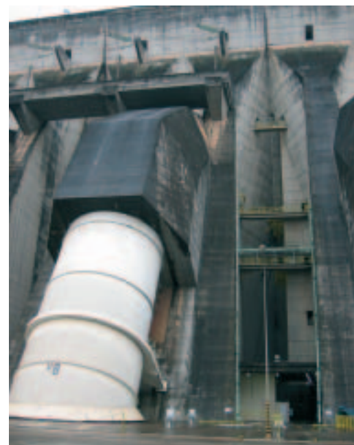
Waterafvoer door een forced conduct pipe.
